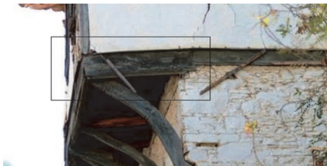
Slika 12. Deformacija horizontalnog drvenog elementa
