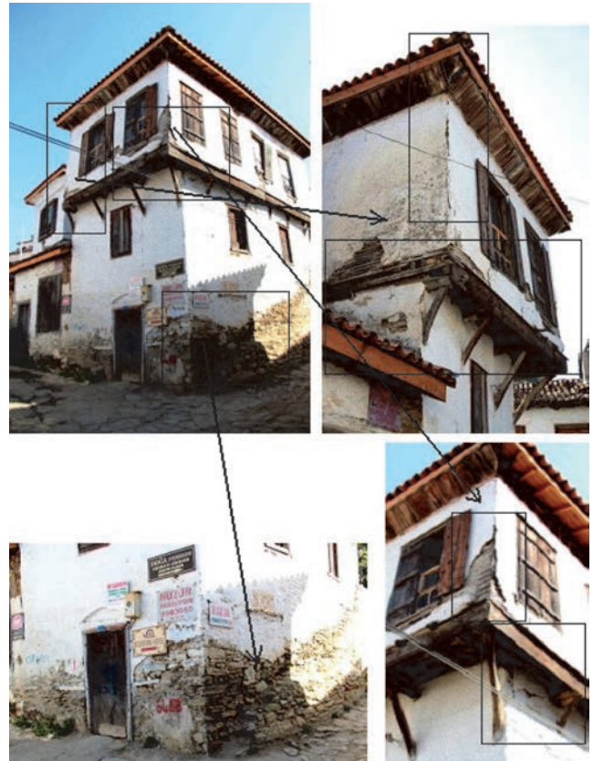
Slika 15. Tipični primjeri oštećenja konstrukcije te degradacije materijala tijekom vremena
