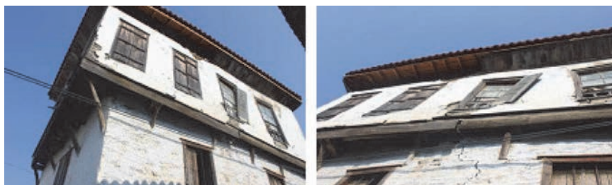
Slika 11. Primjer oštećenja konstrukcije
