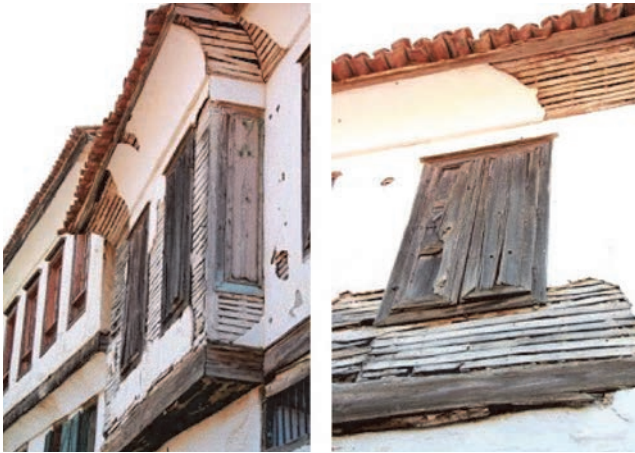
Slika 13. Oštećenje žbuke na zidovima gornjih katova
