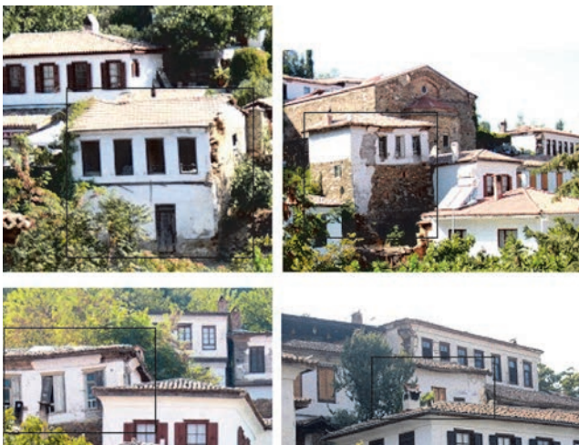
Slika 14. Primjeri oštećenja krovova na tradicijskim Širince kućama
