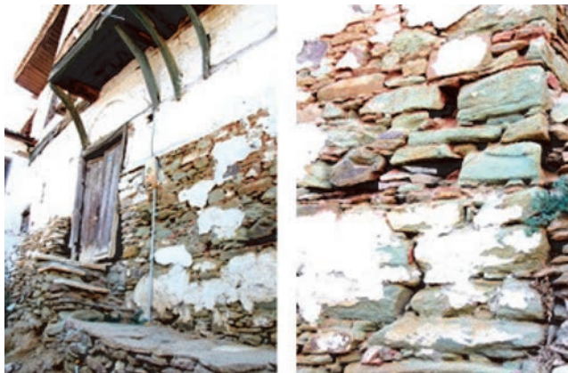
Slika 8. Vertikalne pukotine u uglovima i na vanjskim površinama kamenih zidova u prizemlju (kolovoz 2013.)
