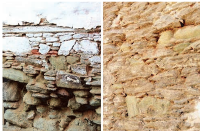
Slika 9. Prikaz propadanja materijala u kamenim zidovima prizemlja (kolovoz 2013.)
